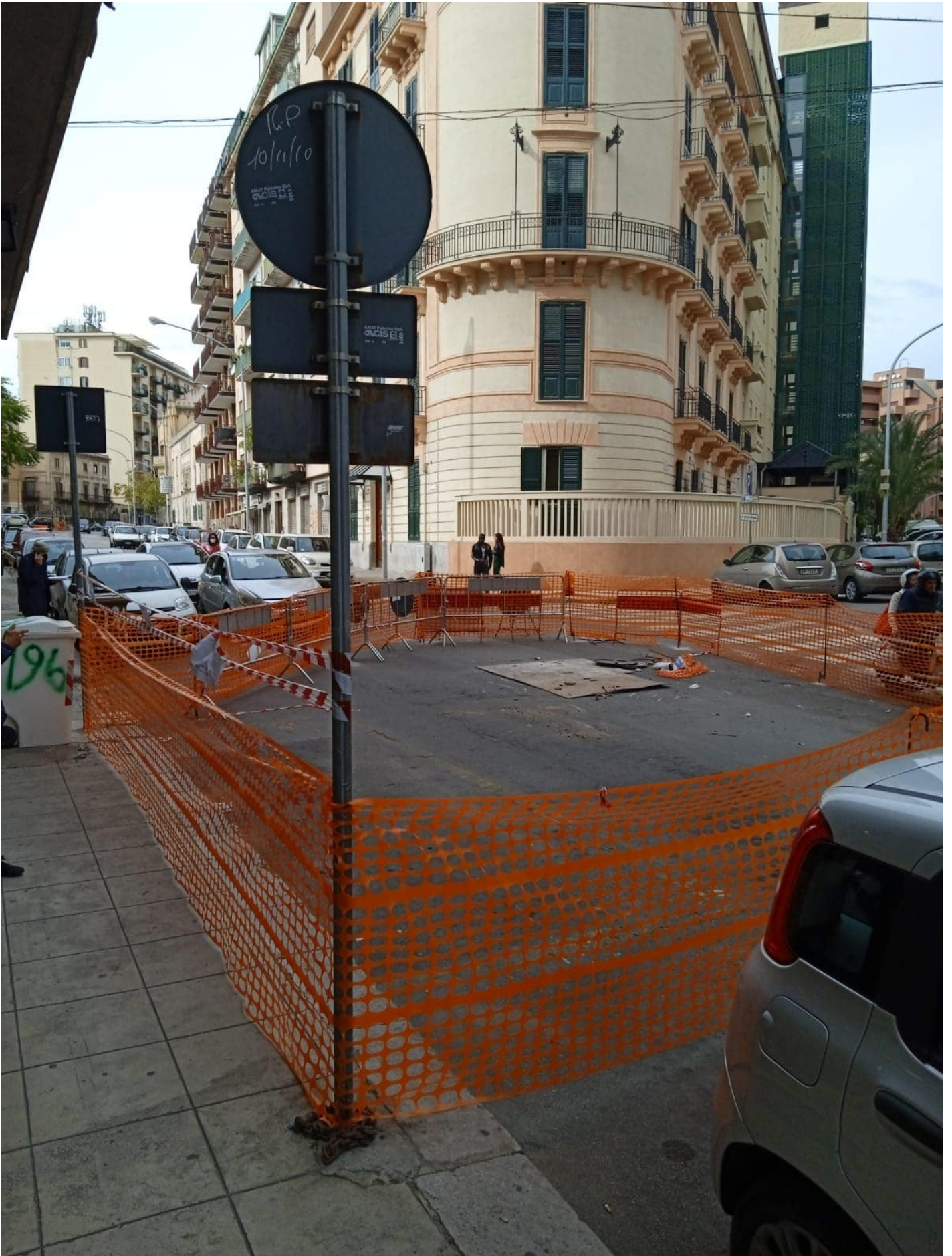
Una voragine si è aperta in Corso Finocchiaro Aprile a Palermo. La causa il cedimento della fognatura. Sono intervenuti i vigili del fuoco, gli agenti della polizia municipale e i tecnici dell'Amap
